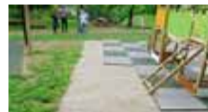
La pavimentazione mancante
