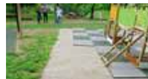
La pavimentazione mancante
