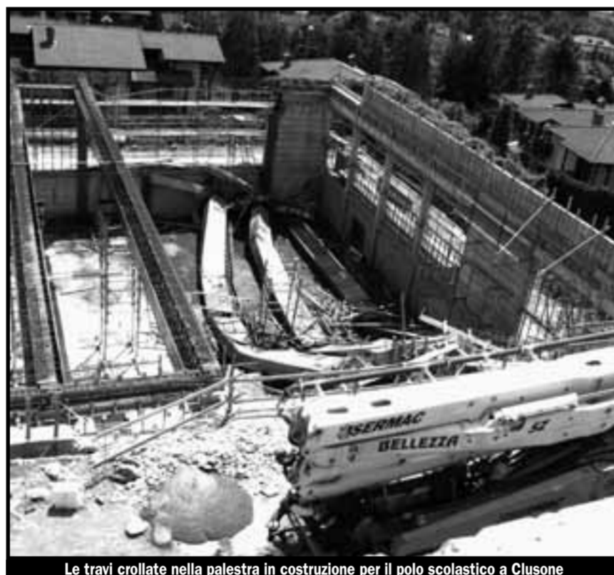
Le travi crollate nella palestra in costruzione per il polo scolastico a Clusone
