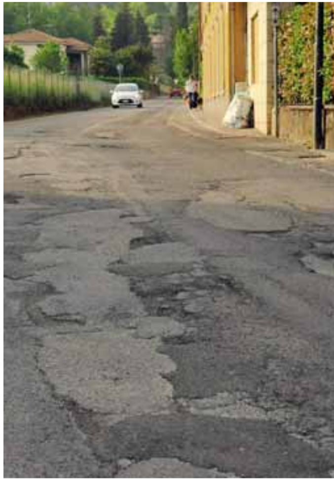
L'asfalto sconnesso in via San Vincenzo de' Paoli a Torre Boldone FOTO BEDOLIS
