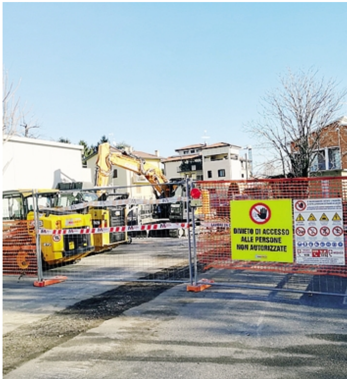
il cantiere nel parcheggio a fianco della stazione ecologica e del parco
