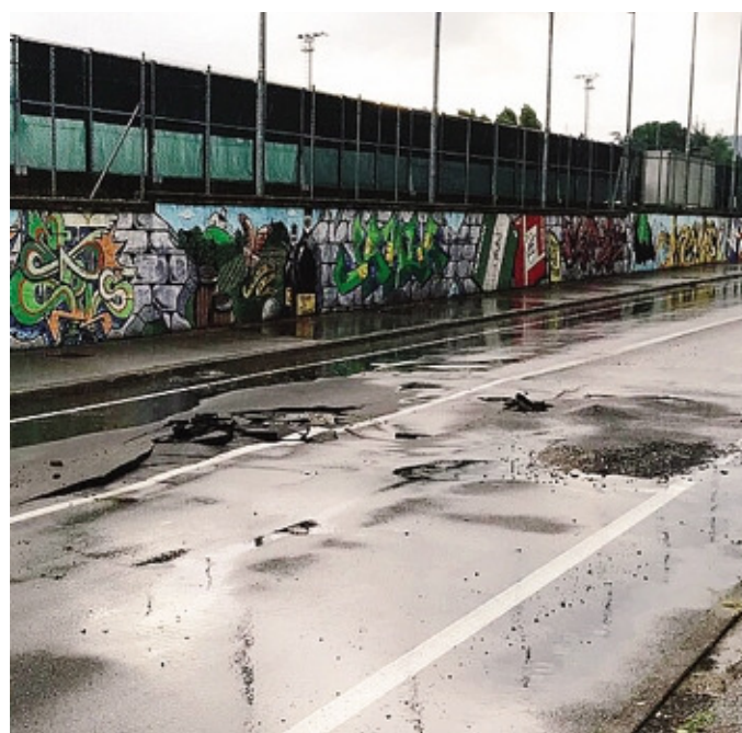
L'asfalto sollevato in più punti per l'acquazzone
