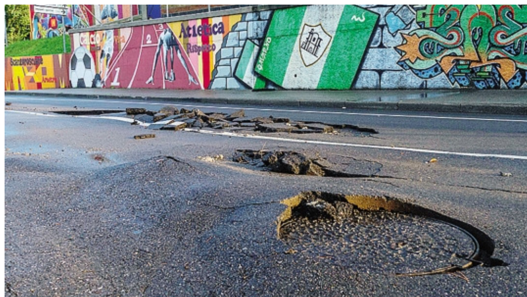
L'asfalto sollevato in via Polcarezzo, a Scanzorosciate, dopo la bomba d'acqua di martedì FOTO PERSICO
