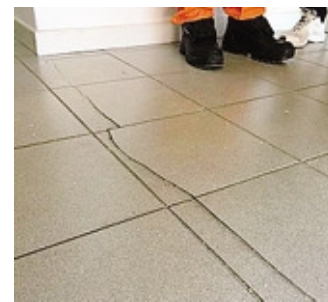
Una crepa nel pavimento
