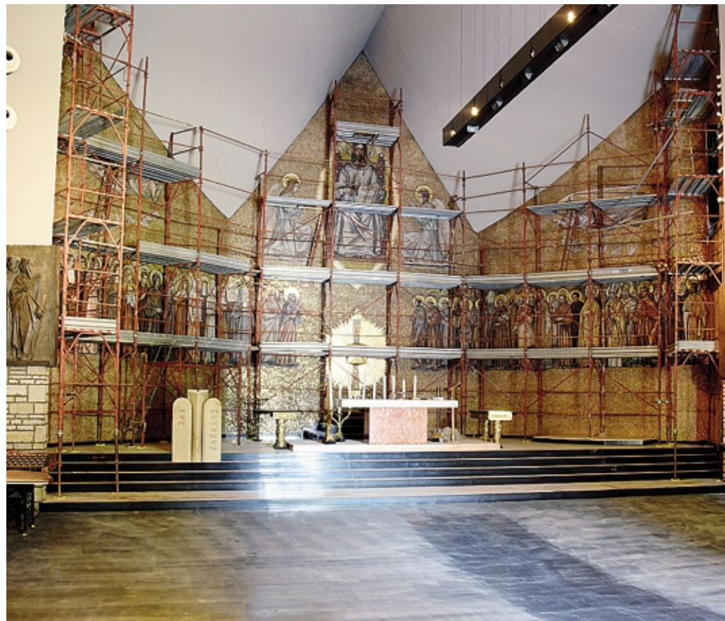
Avanzano i lavori per restituire splendore ai mosaici di Longaretti nella chiesa di Ognissanti FOTO BEDOLIS
