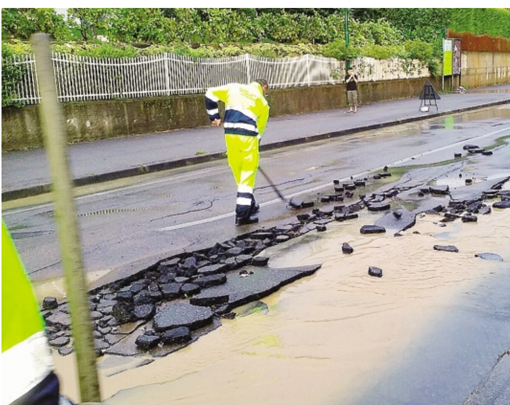
Danni causati dalle bombe d'acqua dello scorso anno a Scanzorosciate
